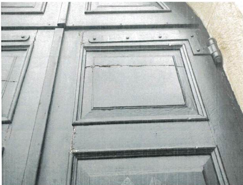
Mikuszowice kościół p. w. Św. Jana Chrzciciela - istniejący stan techniczny drzwi - strona zewnętrzna
