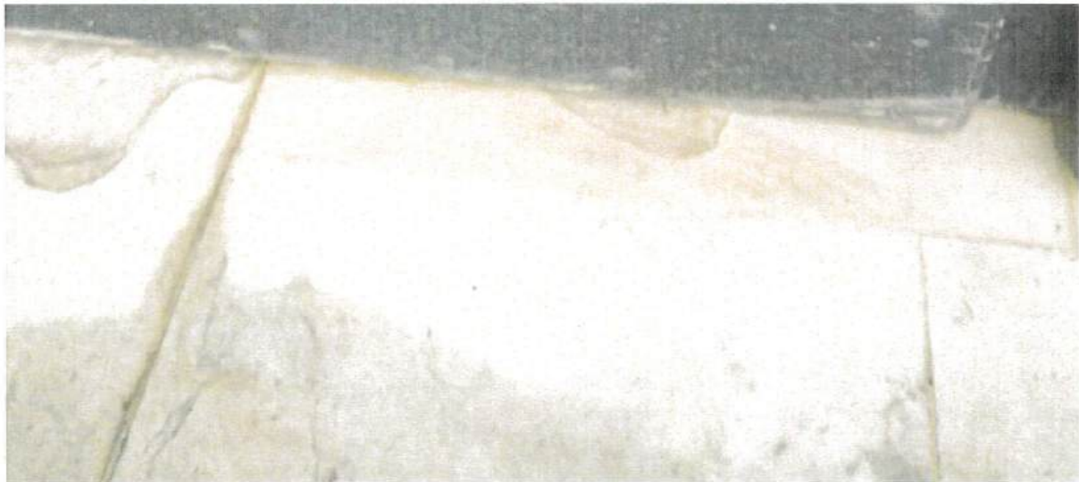
Mikuszowice kościół p. w. Św. Jana Chrzciciela - istniejący stan techniczny schodów
