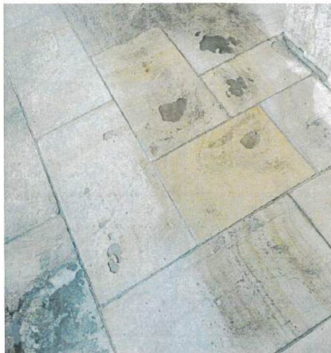
Mikuszowice kościół p. w. Św. Jana Chrzciciela - istniejący stan techniczny schodów
