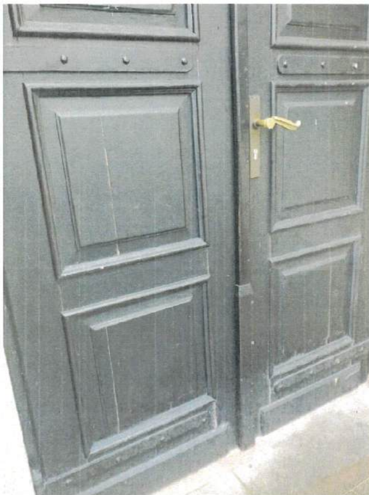
Mikuszowice kościół p. w. Św. Jana Chrzciciela - istniejący stan techniczny drzwi - strona zewnętrzna
