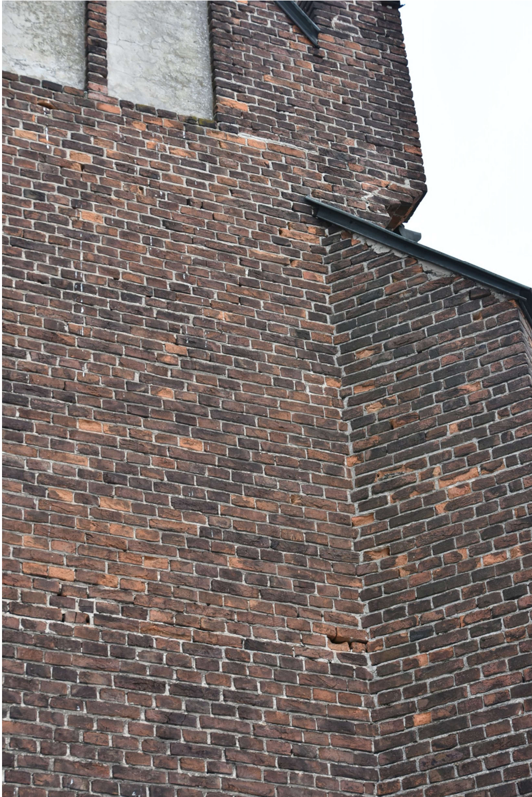
Fot.2. Zabrudzona powierzchnia wątków ceglanych.
