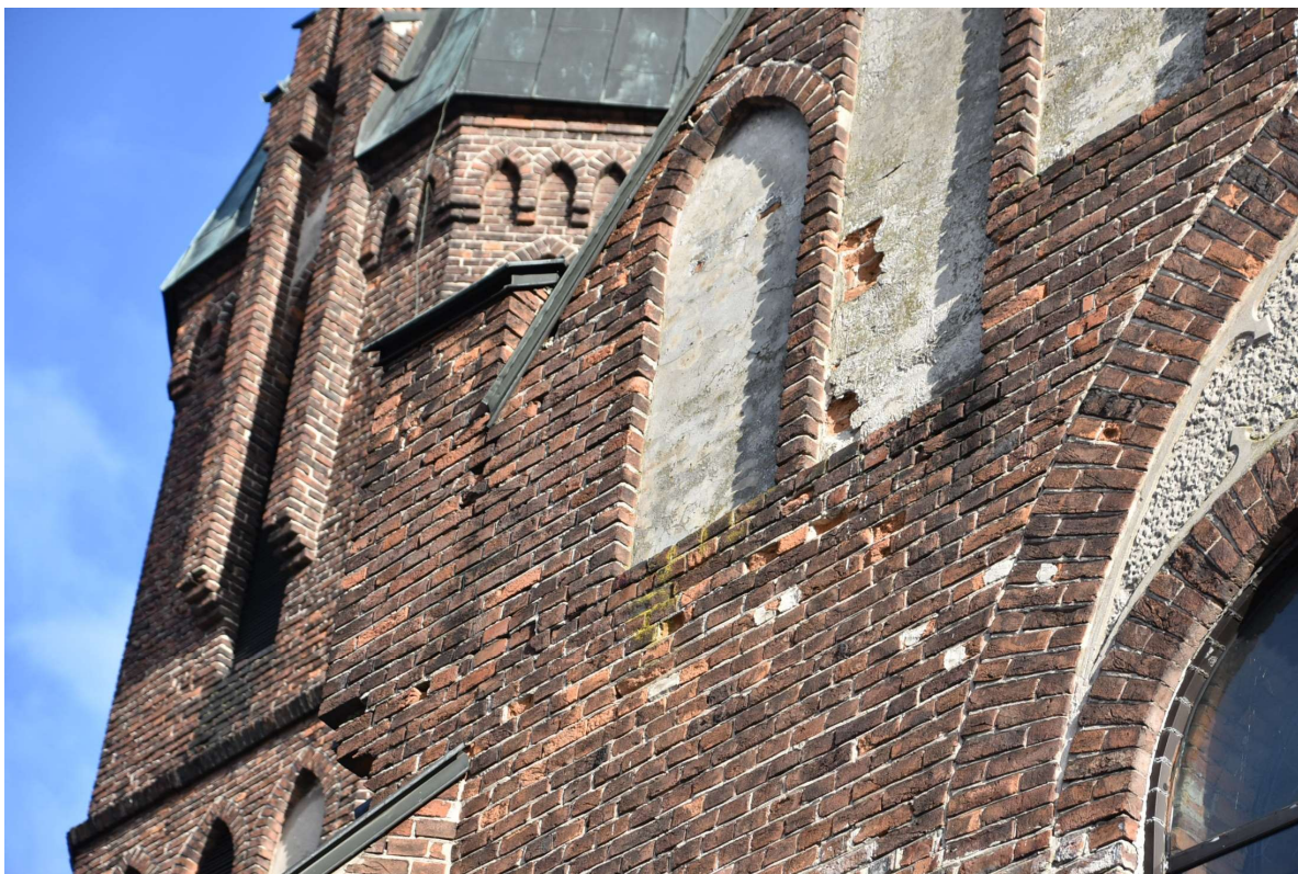
Fot.8. Fragmentaryczne i całkowite ubytki lica cegły
