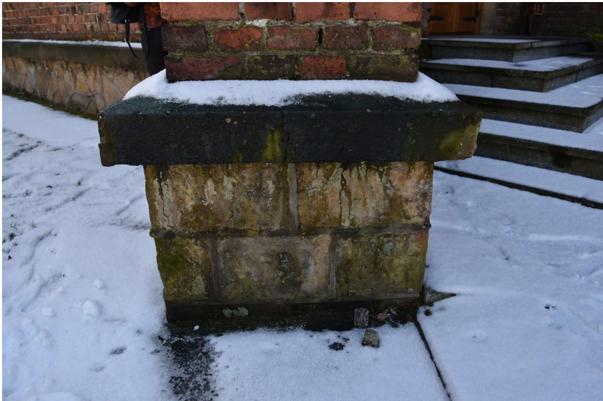
Fot.4. Fragment cokołu porażonego korozją biologiczną
