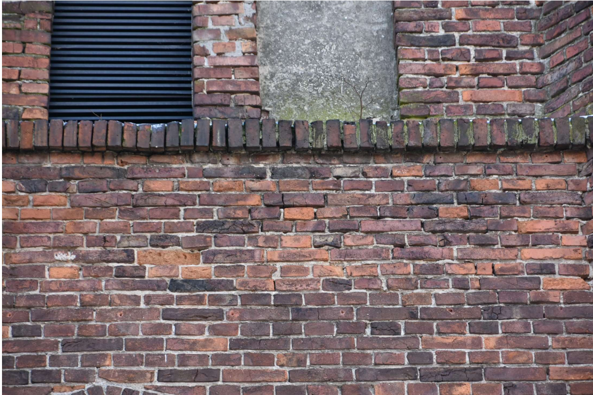
Fot.7. Ubytki lica cegły
