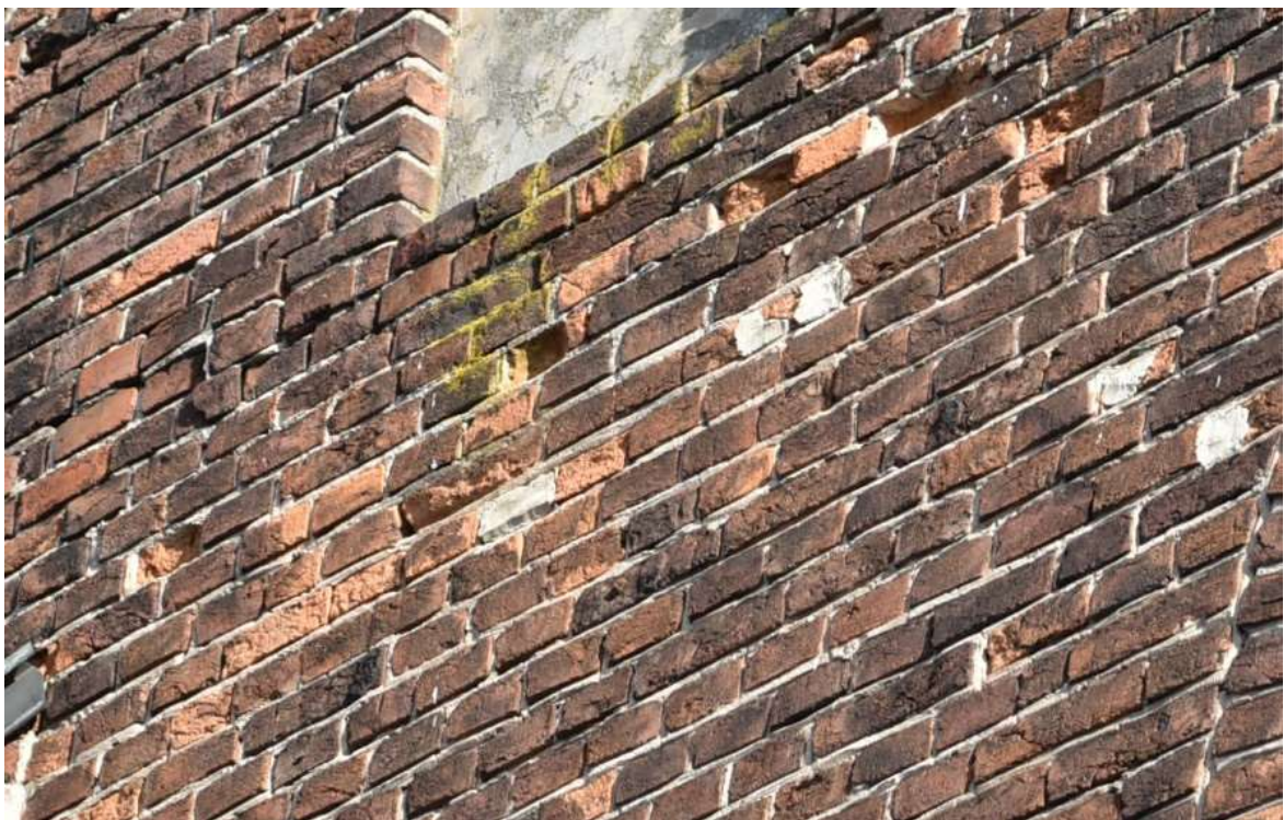
Fot.10. Ubytki pojedynczych sztuk cegieł na wążkach ceglanych elewacji
