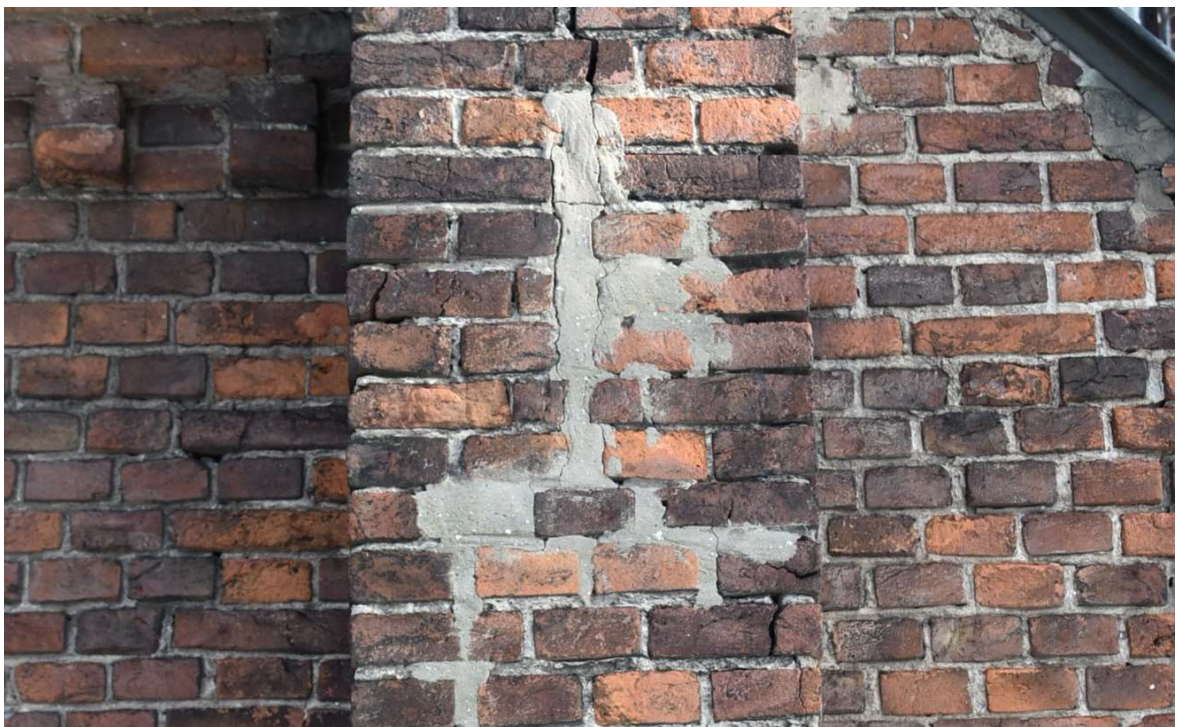
Fot.17. Wadliwe naprawy wążku ceglanego
