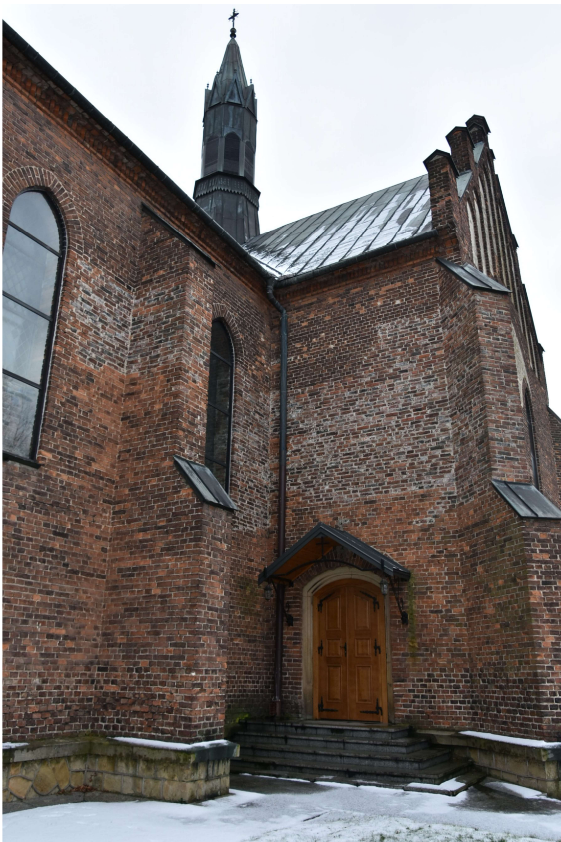
Fot. 13. Wykwity szkodliwych soli
