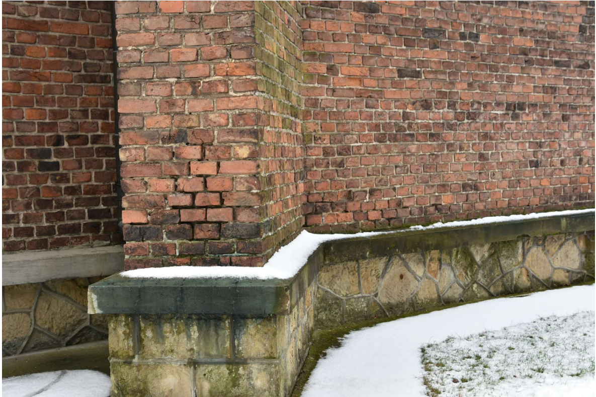
Fot.3. Fragment cokołu porażonego korozją biologiczną
