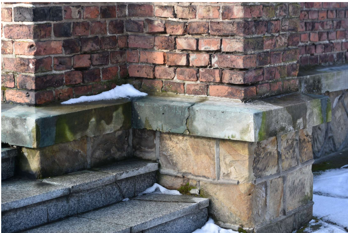
Fot.15. Ubytki spoinowania w dolnych partiach ścian
