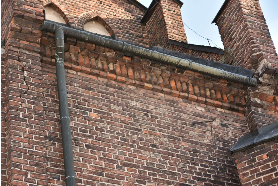
Fot.11. Wyplukana fuga, oraz pojedyncze ubytki cegieł w gzymsie wieńczącym elewację
