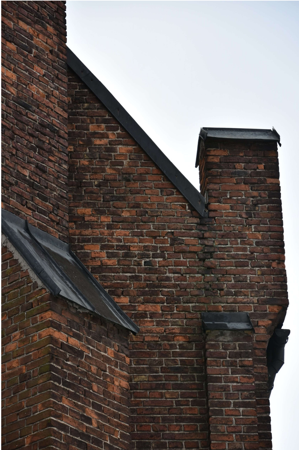
Fot.1. Zabrudzona powierzchnia wątków ceglanych.
