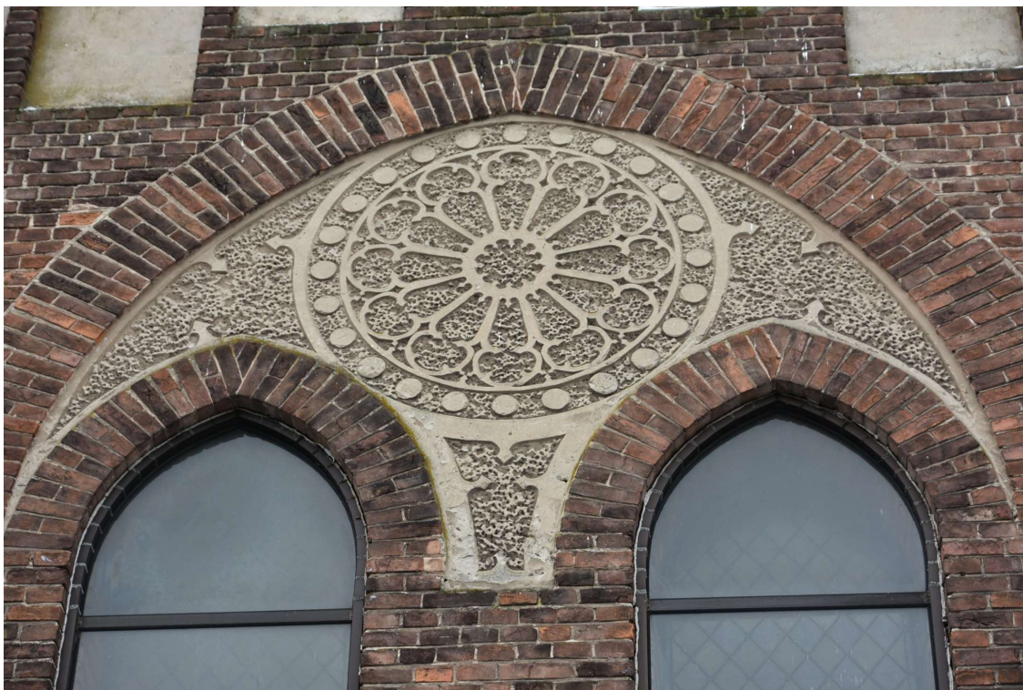
Fot.21. Motyw dekoracyjny na ścianie szczytowej transeptu od strony północnej z widocznymi drobnymi ubytkami
