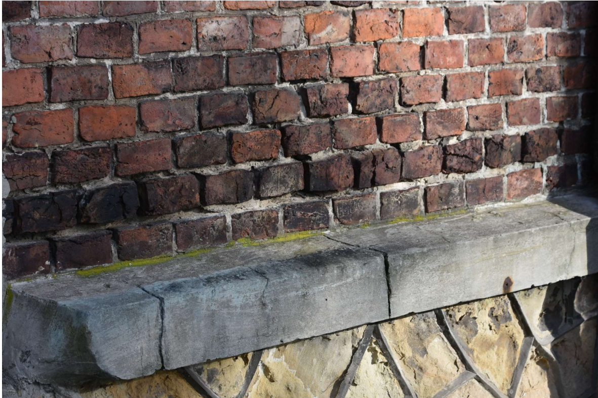
Fot.14. Ubytki spoinowania w dolnych partiach ścian
