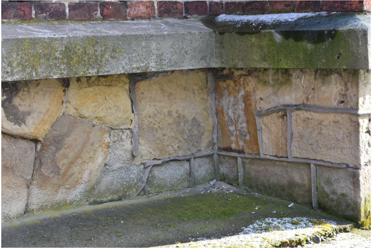
Fot.16. Wykruszona, trójkątna spoina na cokole. Widoczne również zasolenia
