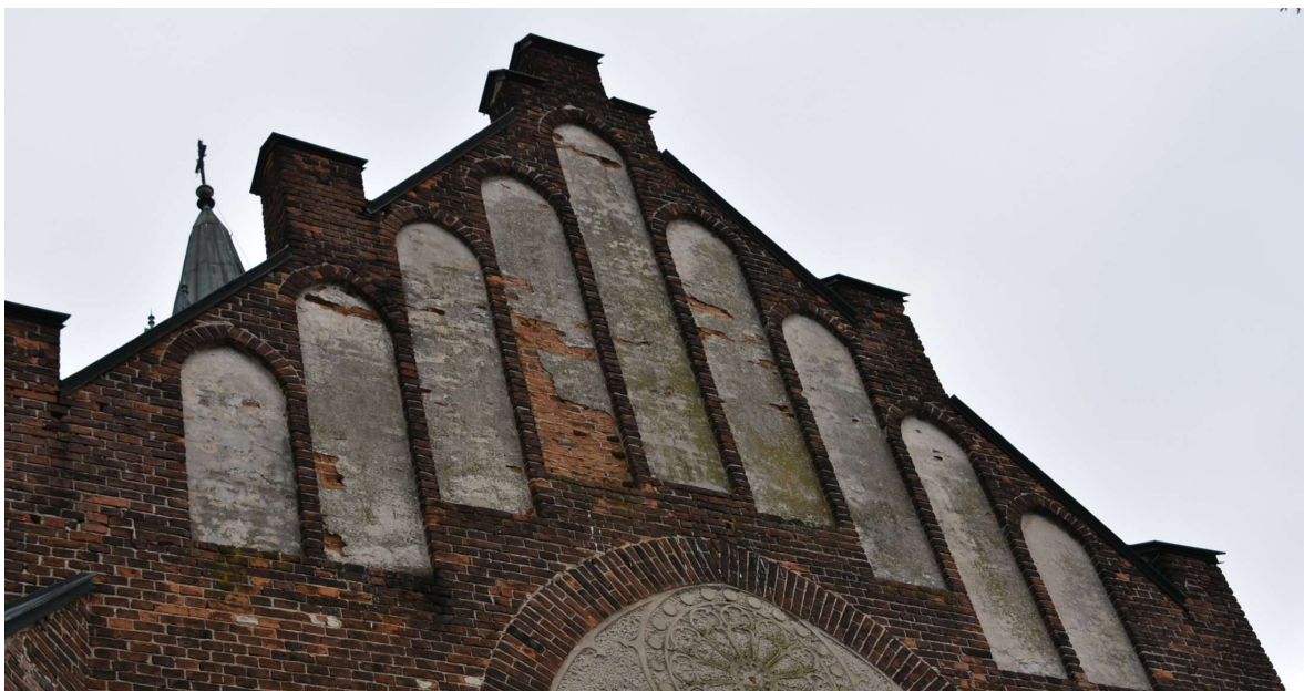
Fot.19. Odspojone tynki na blendach usytuowanych na jednej ze ścian szczytowych
