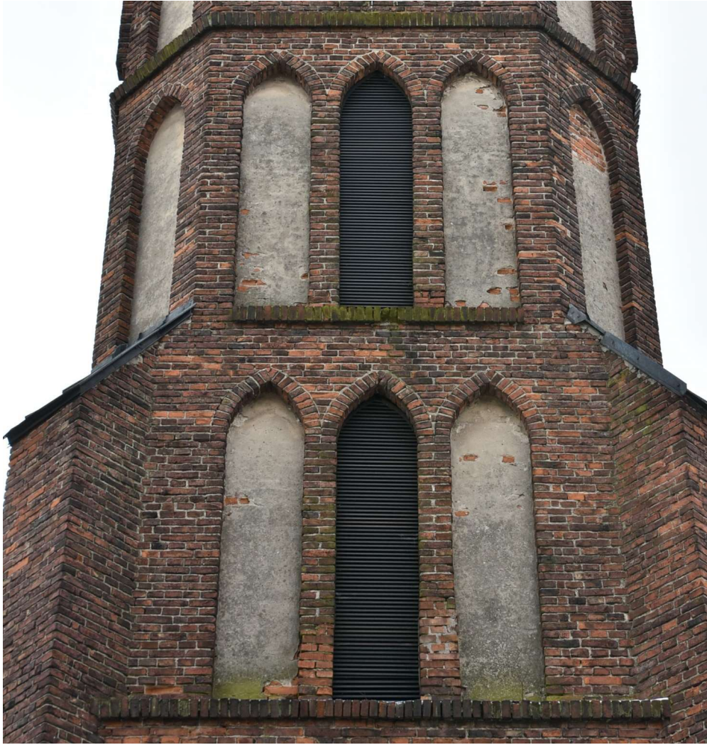
Fot.18. Odspojone tynki w blendach zlokalizowanych na wieży kościoła
