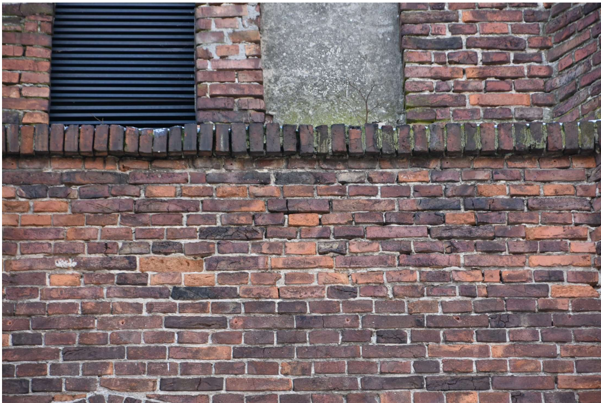
Fot.12. Wyplukana fuga w gzymsie wydzielającym jedną z kondygnacji wieży
